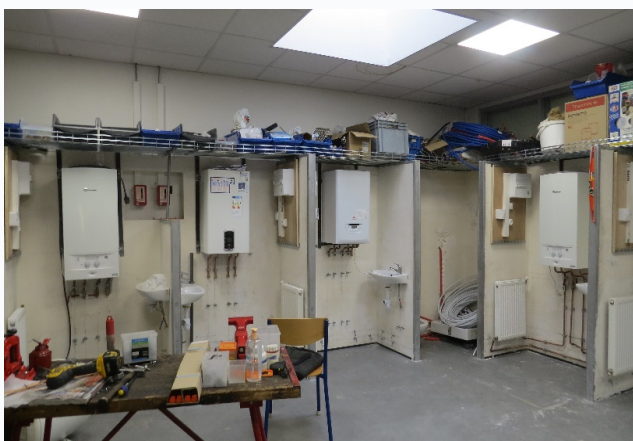
Atelier Plomberie • Chauffage
